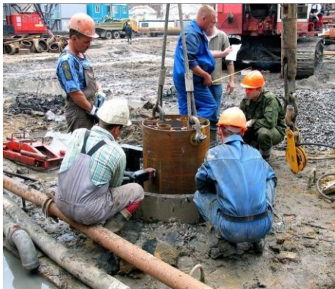
Hình 6: Cột chống tạm được hạ cố định trong hố khoan cọc khoan nhồi [6]
